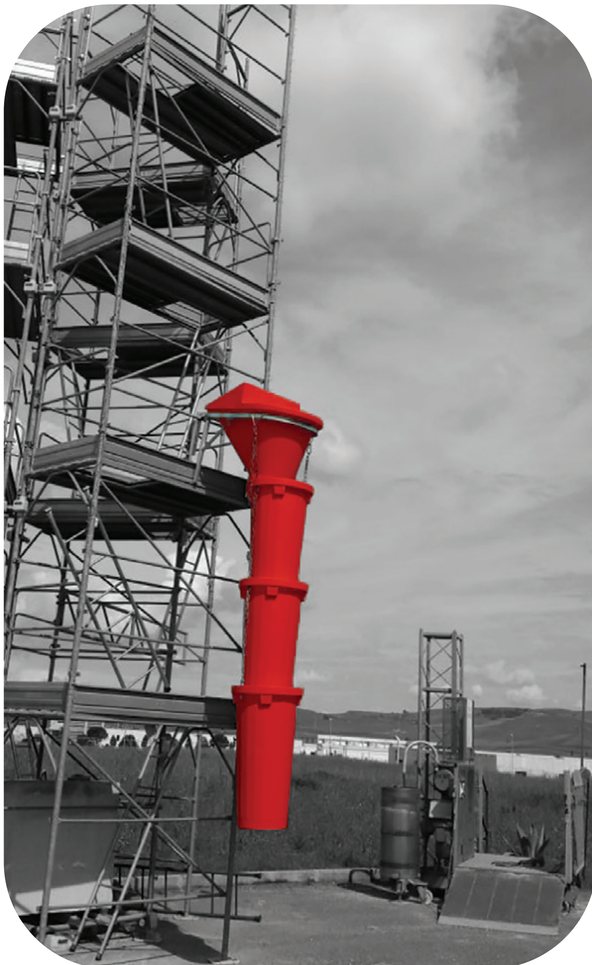
in foto: scivoli detriti, tramoggia e supporto
